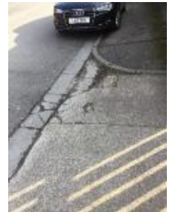
Arwyneb wedi cracio.
